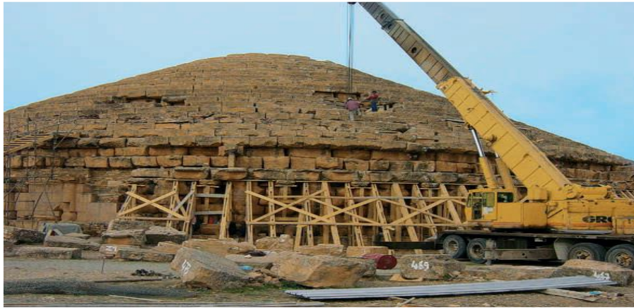
photo 11 : travaux de restauration inadaptés sur le tombeau
