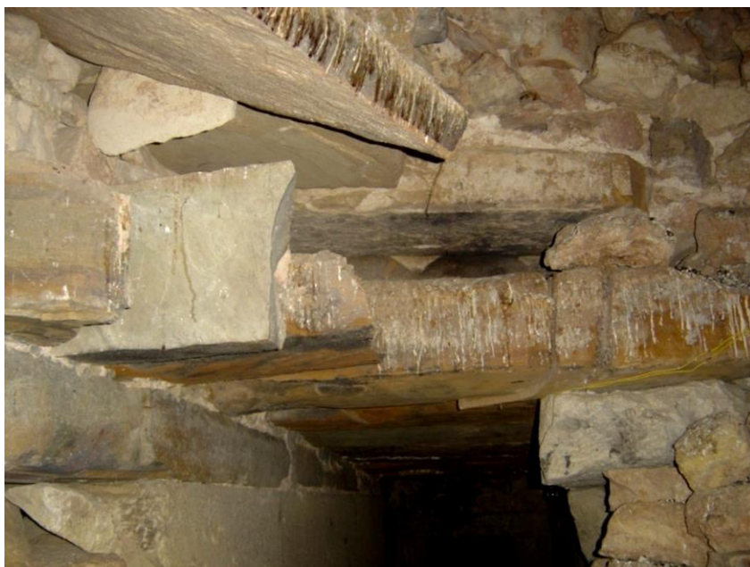
photo 8: Déjections de chauves-souris sur le plafond du couloir d'accès aux chambres sépulcrales. Djeddars
