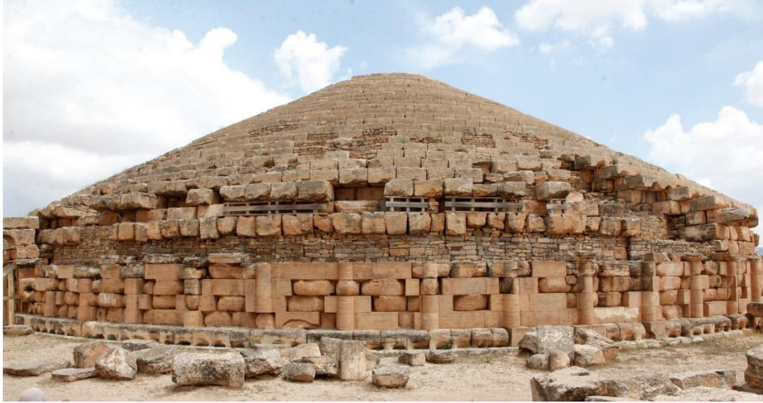
photo 12 : restauration inadéquate Source : Auteure Aout 2018
